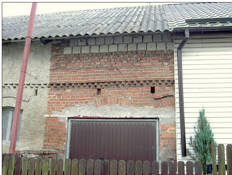
Rys. 1. Przykrywanie ozdobnych fryzów oraz przekształcenia otworów okiennych i drzwiowych, Tyrowo, wrzesień 2011 r. (fot. autor)
